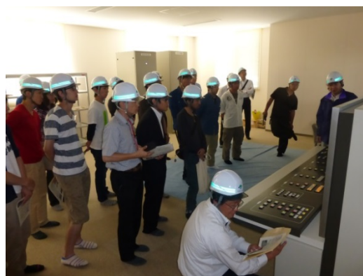
本郷排水機場のコントロール室
