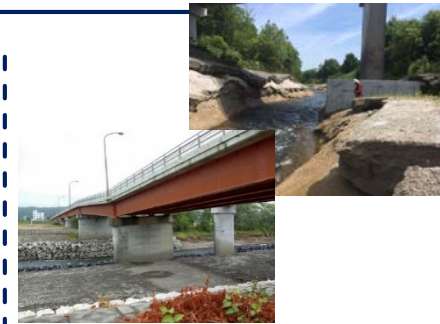
＜オホーツク管内での被災事例＞
